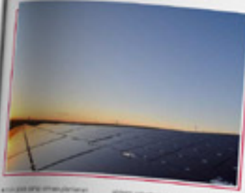
Yeni kurulu elektrik üretim ve dağıtım tesisleri
